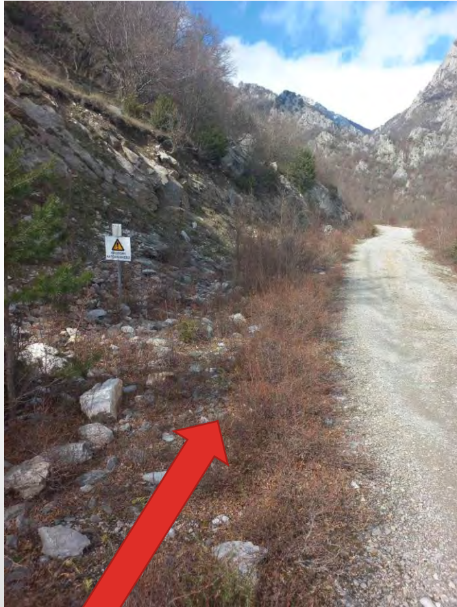
Θαμμένος Αγωγός Προσαγωγής ~2,5m και καλώδιο Μ.Τ. 3.0kV με οπτική ίνα
