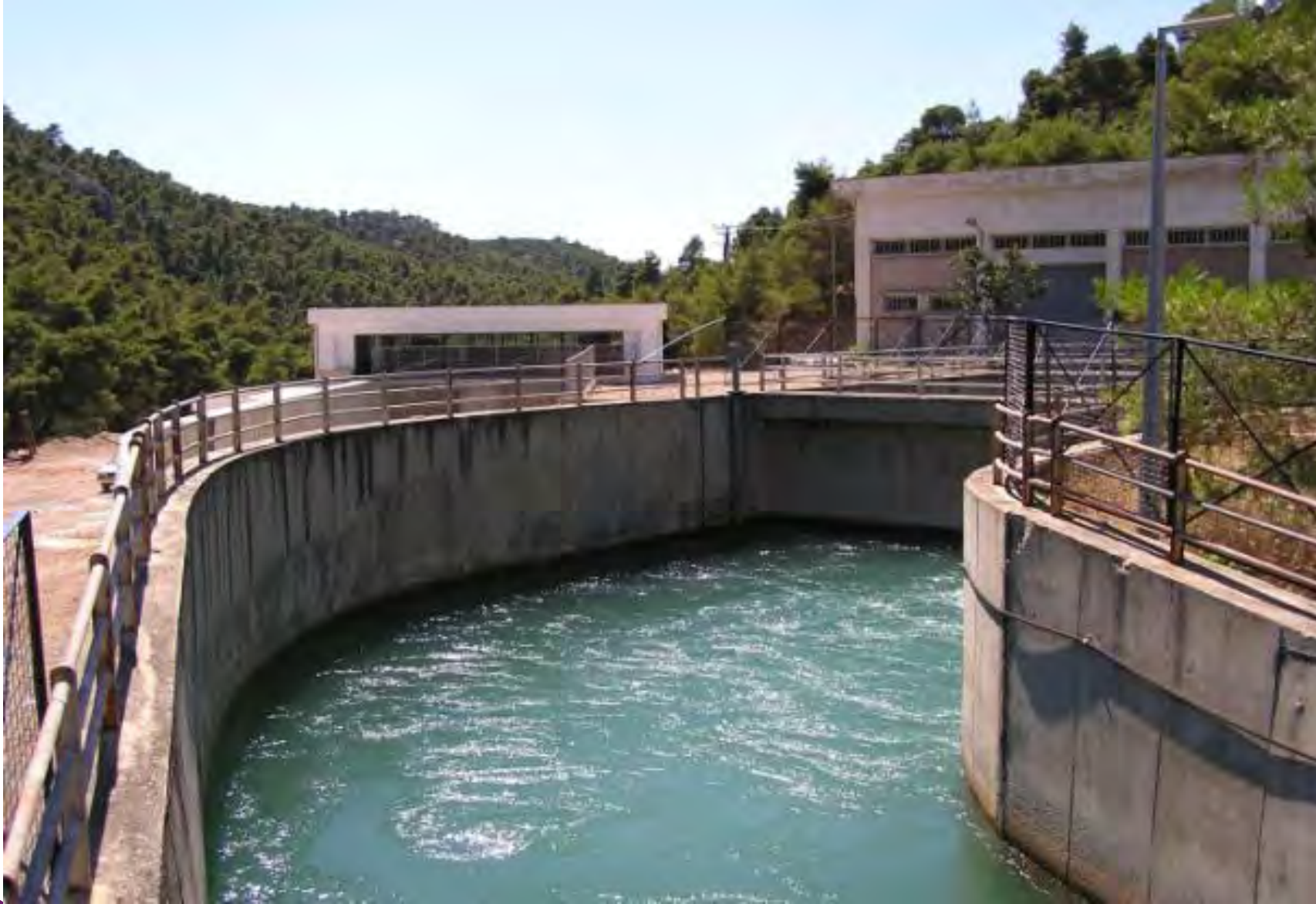
Ο υδαταγωγός του Μόρνου στην έξοδο υφιστάμενου ΕΚΕ
