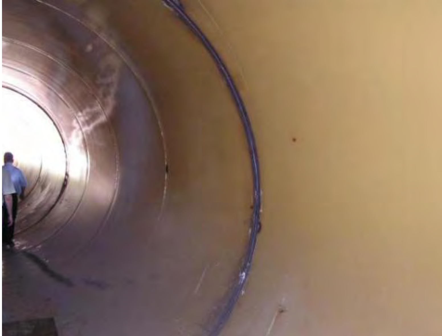
Άποψη του αγωγού προσαγωγής του ΜΥΗΕ Κιθαιρώνα
